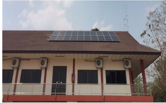
โครงการติดตั้งระบบไฟฟ้าพลังงาน แสงอาทิตย์เพื่อประหยัดไฟ สำนักงานองค์การบริหารส่วนตำบลแม่กรณ์
